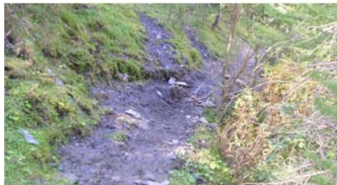
Tracciato compromesso da ripristinare
