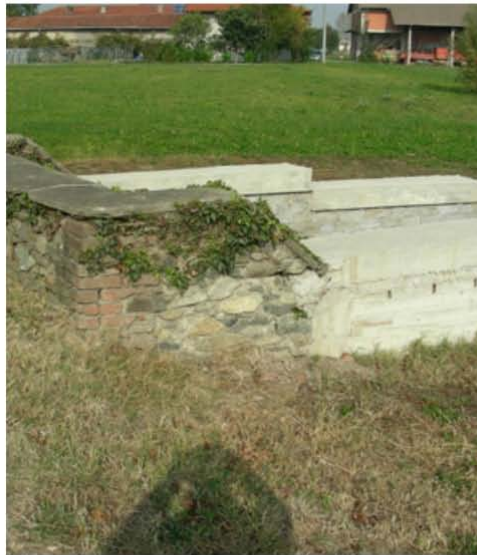
intervento non coerente su un canale storico
